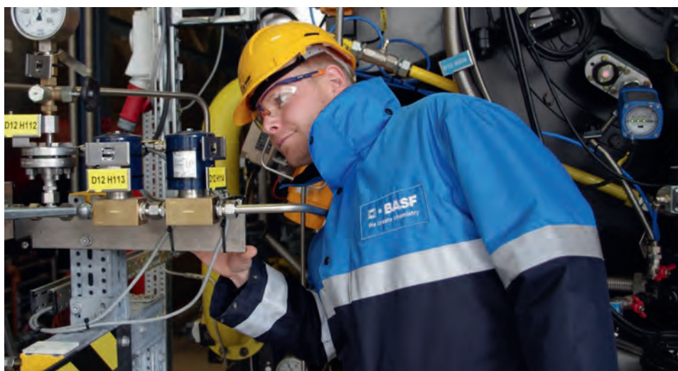
Sur le site de Kaisten, quatre nouvelles chaudières à vapeur participent à l'amélioration de la performance énergétique.
