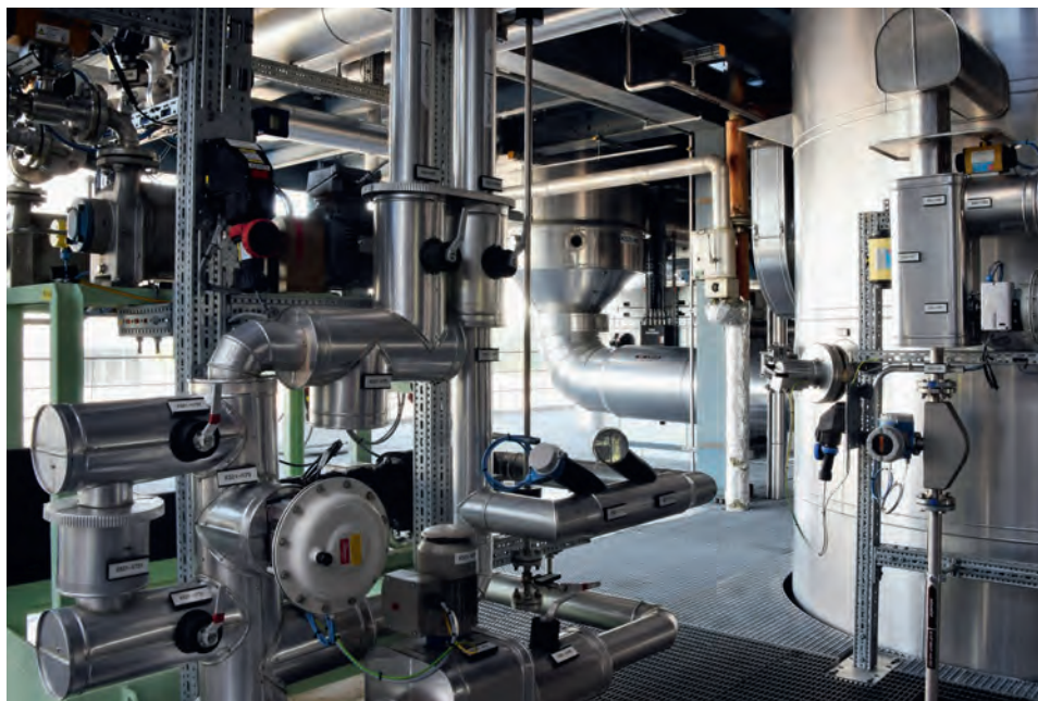
Fortement automatisée, l'installation mono-produit de Kaisten est très performante énergétiquement.
