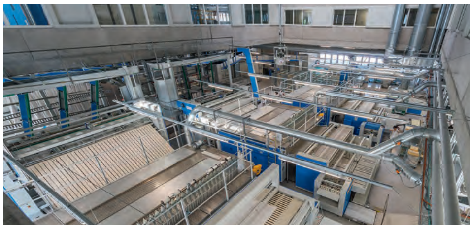
La chaleur rejetée par les trois plieuses est valorisée dans un accumulateur thermique d'une capacité de 30 m 3 .
